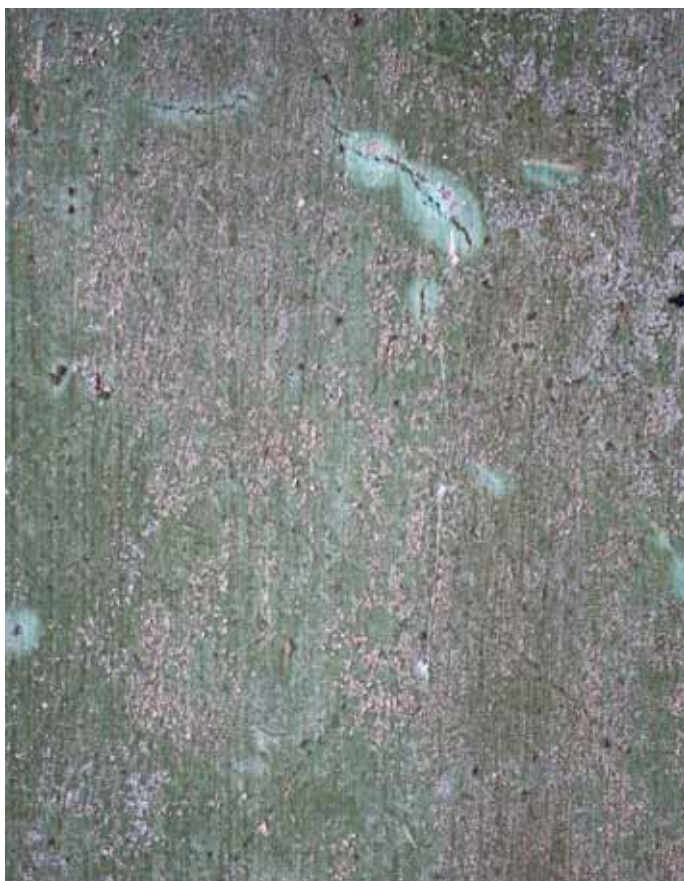
1 - Over: Malt overflate med rester av tapetlim og lysere partier hvor malingsjiktet er revet av sammen med tapetet.
